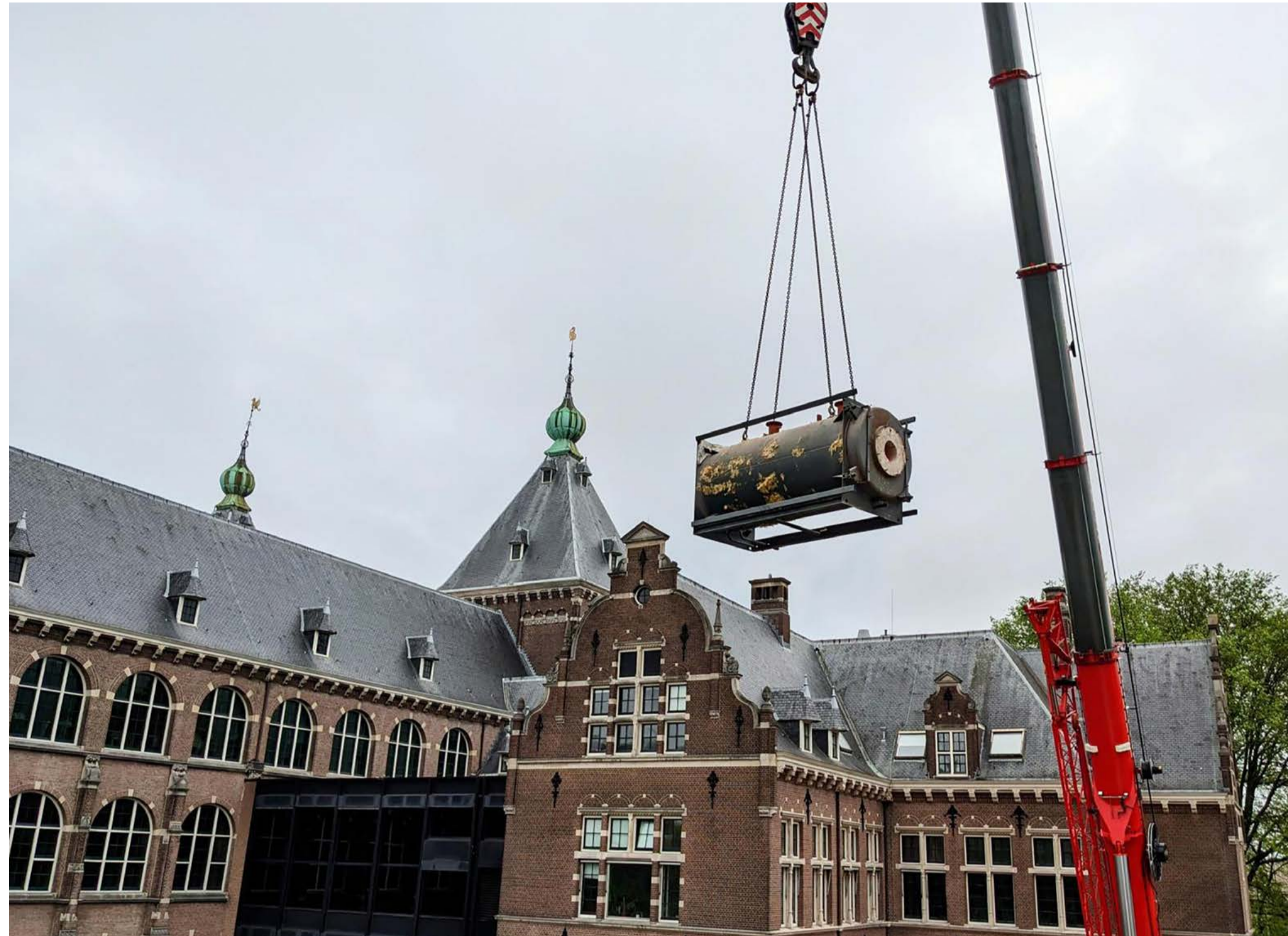
Mei 2023 werden de gasketels van het KIT vervangen door warmtepompen en WKO. Foto De Groene Grachten.
